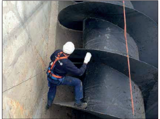
Baraki STP, Algeria
